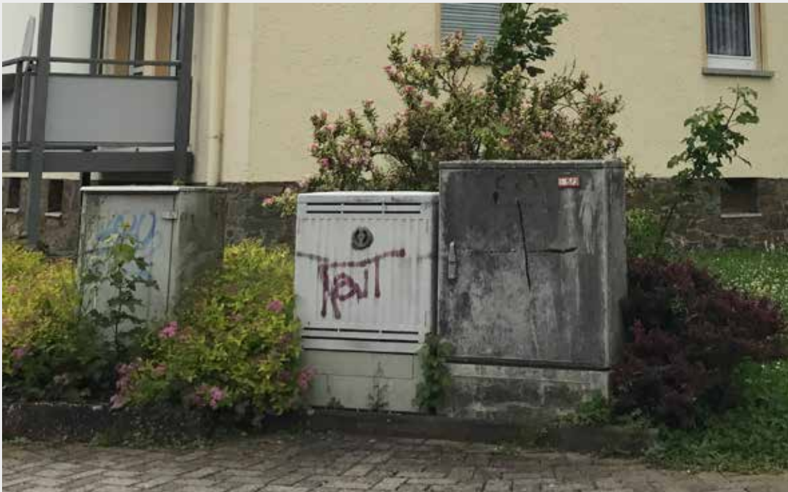
Abbildung 42: Schmierereien im Programmgebiet, Quelle: NH ProjektStadt (2017)
