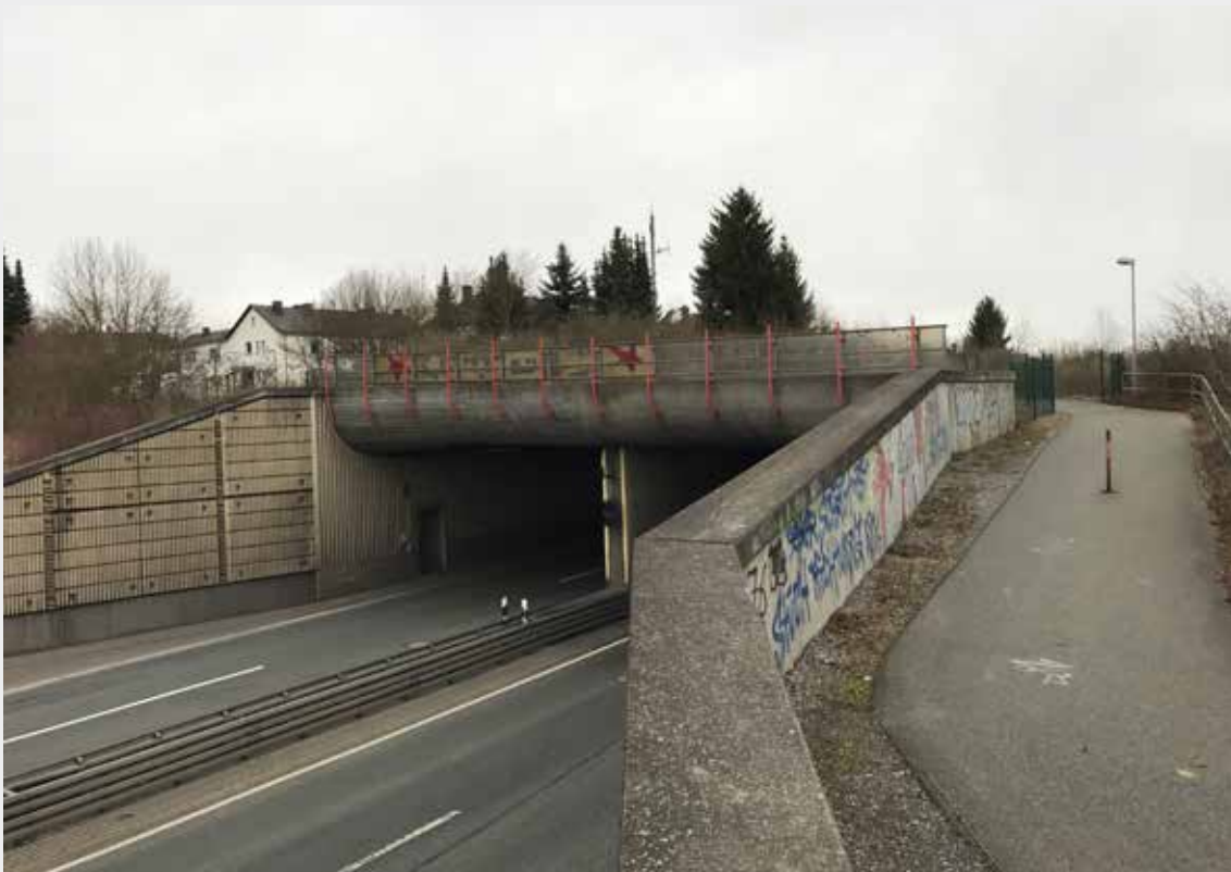
Abbildung 72: Tunnel Wetzlar, Quelle: NH ProjektStadt (2017)
